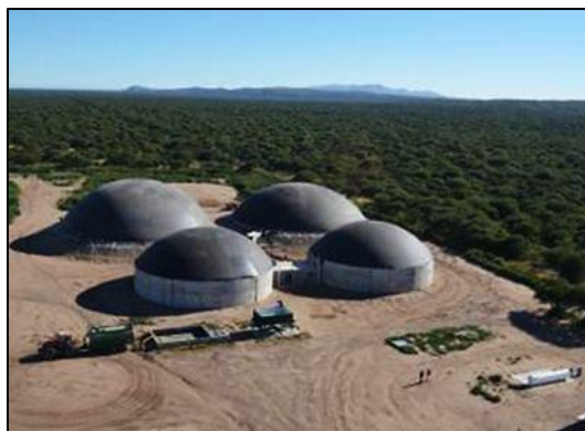
Biodigestores instalados en el establecimiento Yanquetruz en San Luis.
