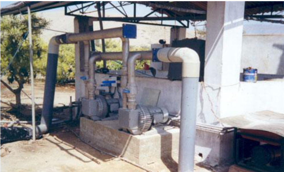
Turbinas para el transporte del biogas a los lugares de consumo
