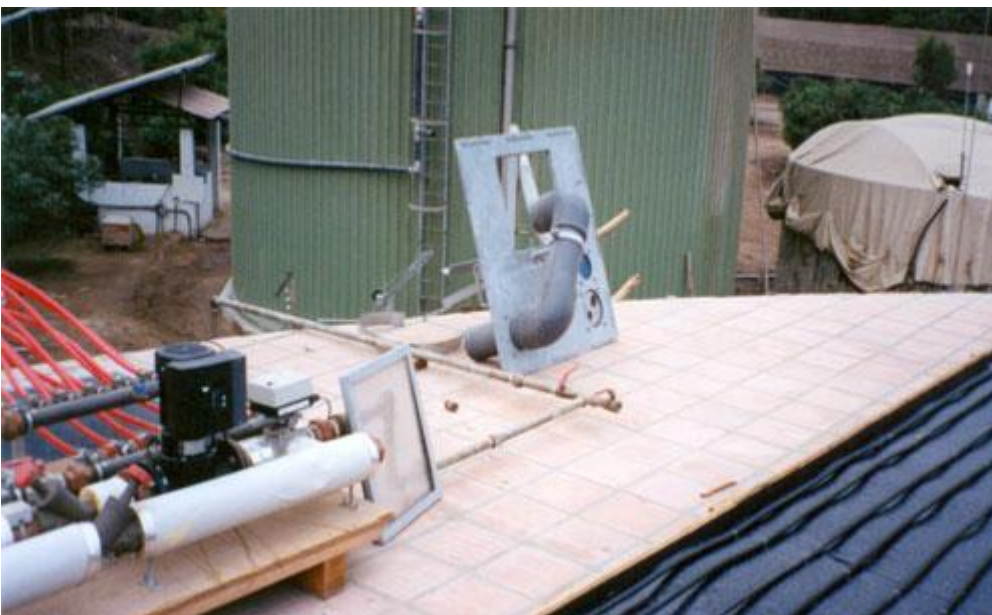
Válvulas de seguridad del Biodigestor y sistema de comando de la calefacción
