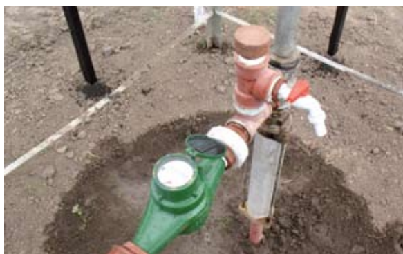
Caudalímetro instalado en el molino para evaluar el volumen extraído en el tiempo.
