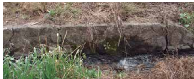
Roturas en el canal donde se produce infiltración y que con el tiempo pueden originar asentamientos y mayores roturas.
