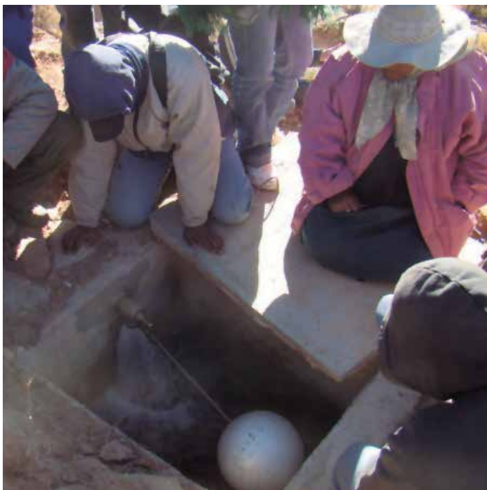
Cámara rompecarga y flotante de alta presión. Urcuro, Salta.
