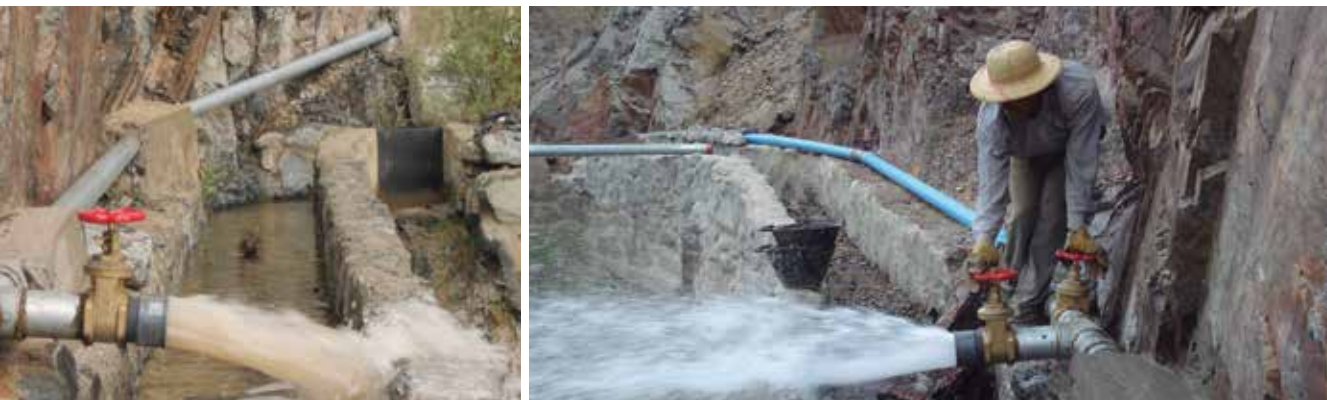
Válvulas de limpieza.
