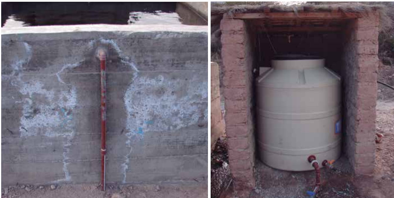
Tuberías de polipropileno en cisternas.
