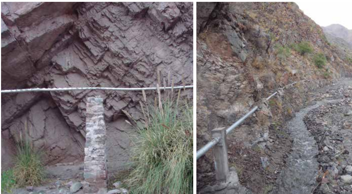
Anclaje de la tubería en quebradas. Comunidad Huachichocana, Jujuy y San Antonio, Salta.
