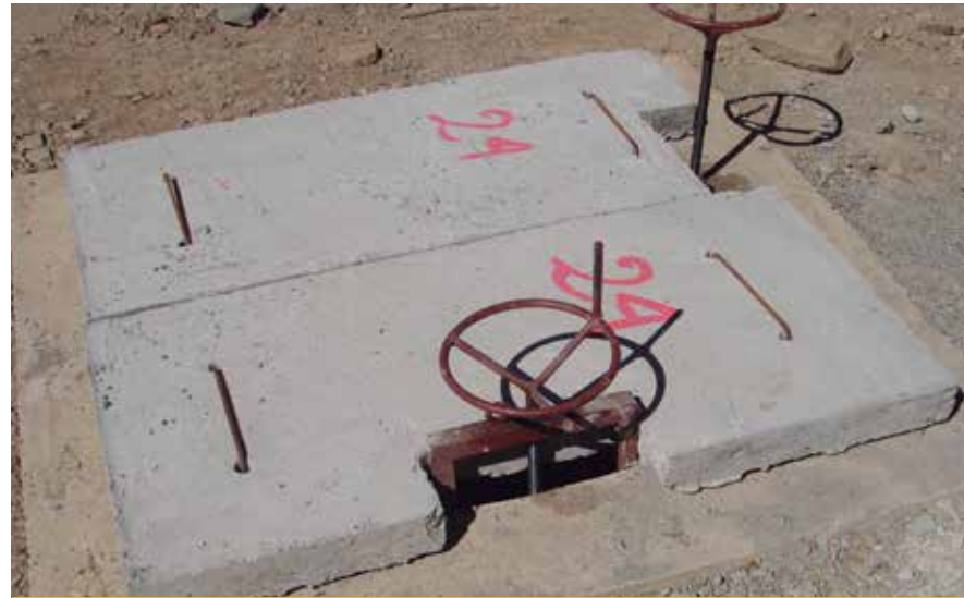
Partidor y compuertas.
