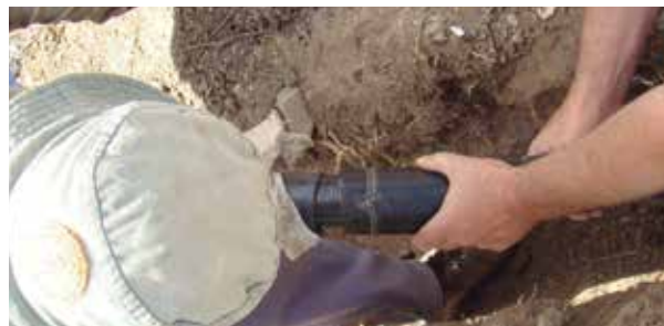
Unión de tuberías de polietileno con espigas. Comunidad Urcuro, Salta.
