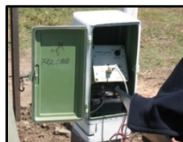
Figura3- Freatígrafo digital instalado en el Sistema A.
