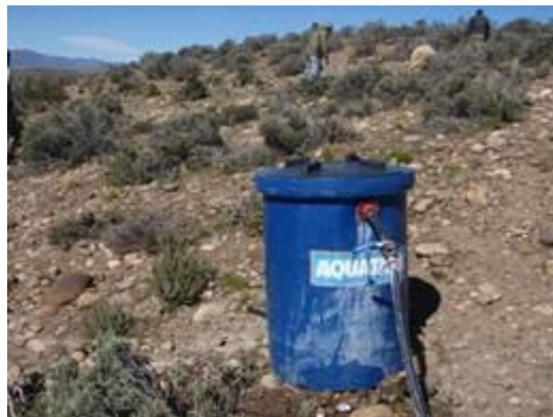
Foto 8. Tambor rompecarga para evitar sobrepresiones en el sistema que puedan romper cañerías y uniones de manguera.
