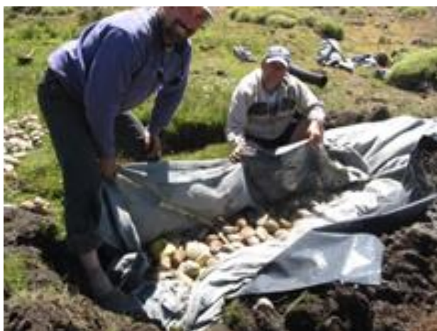
Foto 6. Recubrimiento con piedras del lugar del caño ranurado previo a terminar de envolverlo con la malla de geotextil.
