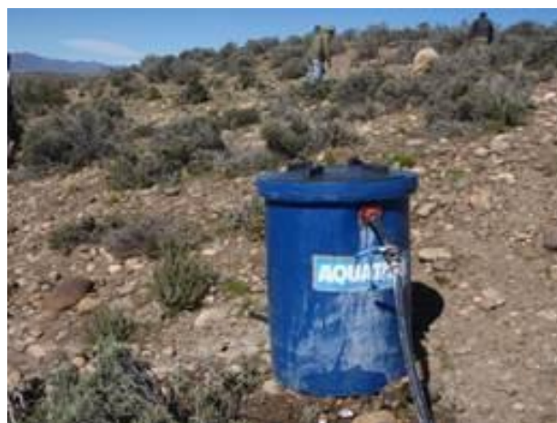
Foto 8. Tambor rompecarga para evitar sobrepresiones en el sistema que puedan romper cañerías y uniones de manguera.
