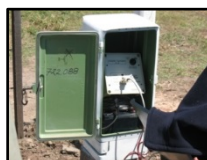
Figura3- Freatígrafo digital instalado en el Sistema A.
