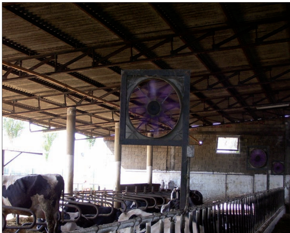
Figura 1: Línea de ventiladores sobre una cornadiza.
