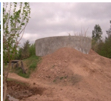
Tanque australiano de mampostería - Sáenz Peña.
