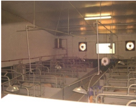
Maternidad con paneles humidificadores y extractores - General Vedia - Chaco.
