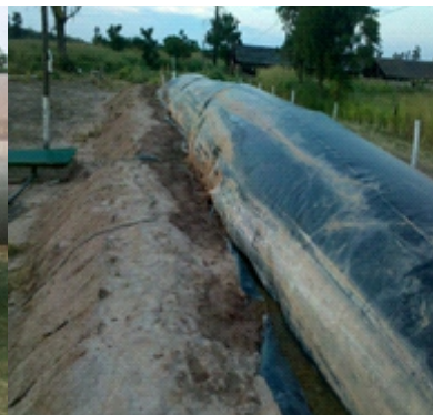
Gasógeno – Biogás - Las Breñas.
