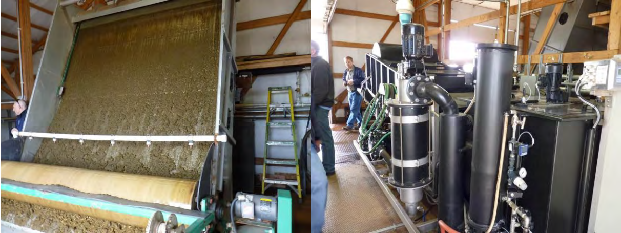
Separados primario de sólidos
