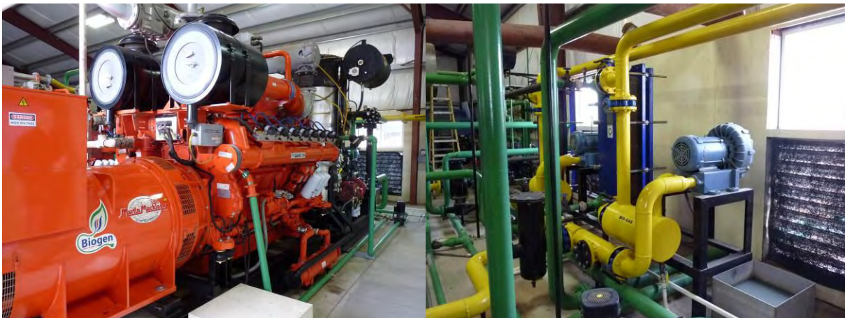
Grupos generadores de electricidad
