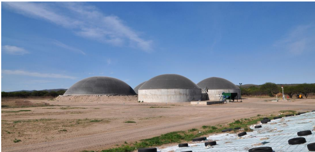
6 – Planta de biogás en funcionamiento en la provincia de San Luis, en el establecimiento Yanquetruz.
