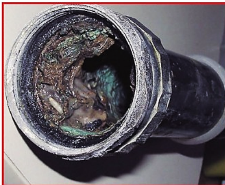
Figura 4. La presencia de biofilm en las tuberías favorece la contaminación microbiológica del agua.
