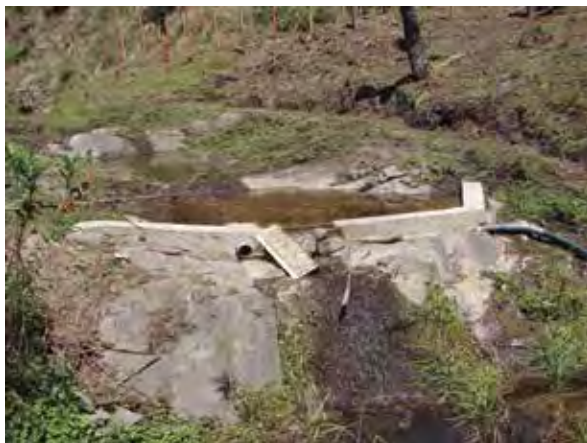
Muro de represamiento transversal en pequeña quebrada.
