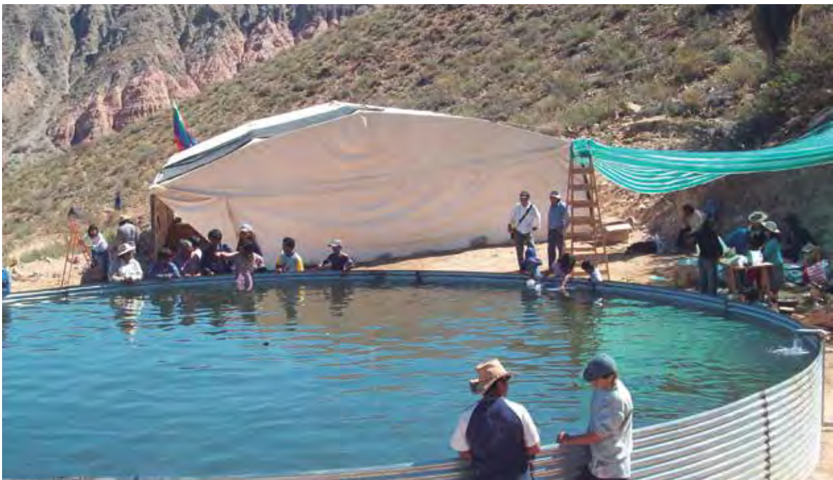
Tanque australiano. Obra hídrica comunitaria de la Comunidad Aborigen Villa El Perchel. Departamento Huacalera, Quebrada de Humahuaca, Jujuy.
