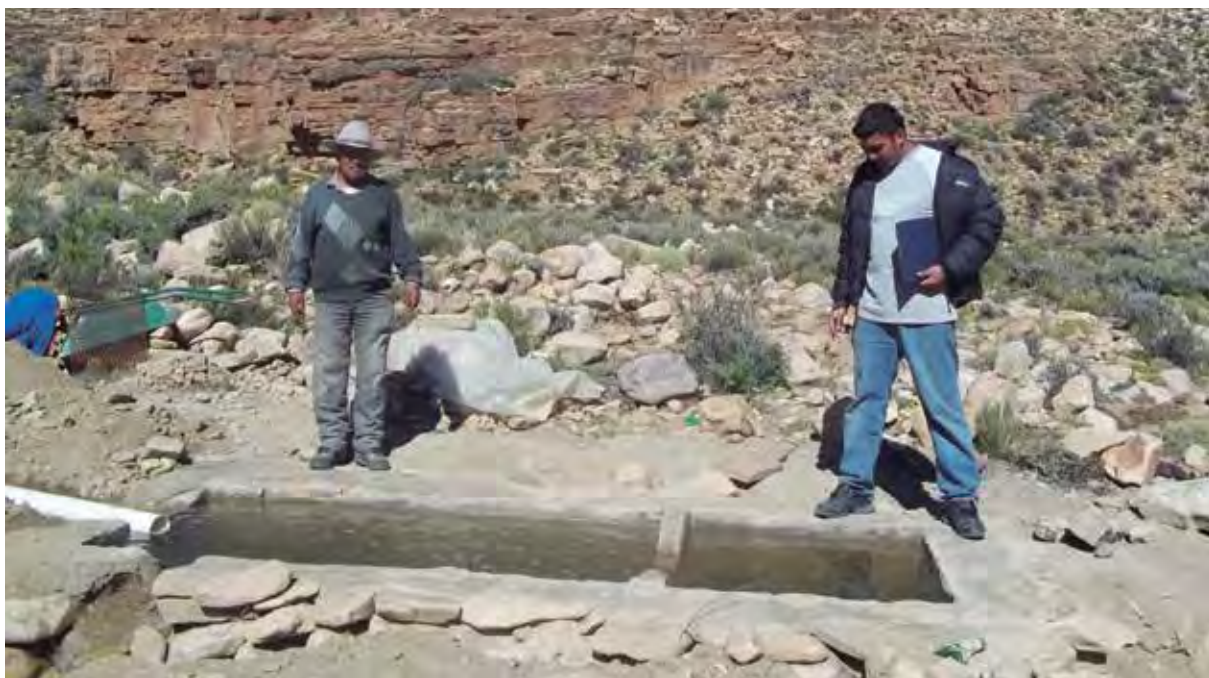
Desarenador ubicado aguas abajo de la toma libre del paraje Peña Alta. Comunidad Aborigen El Angosto.
