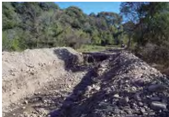
Excavación para el emplazamiento de un dren en la localidad de Vaqueros (Departamento La Caldera, provincia de Salta). Foto: Juan Pablo Zamora Gómez.
