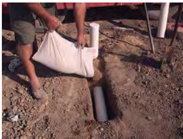
Agregado de grava alrededor del caño-filtro horizontal que se encuentra a 0,5 m de profundidad.
