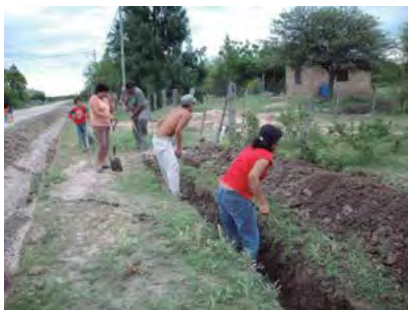
Vecinos de Fortín Charrúa instalando la cañería de distribución que abastecerá un grifo comunitario.
