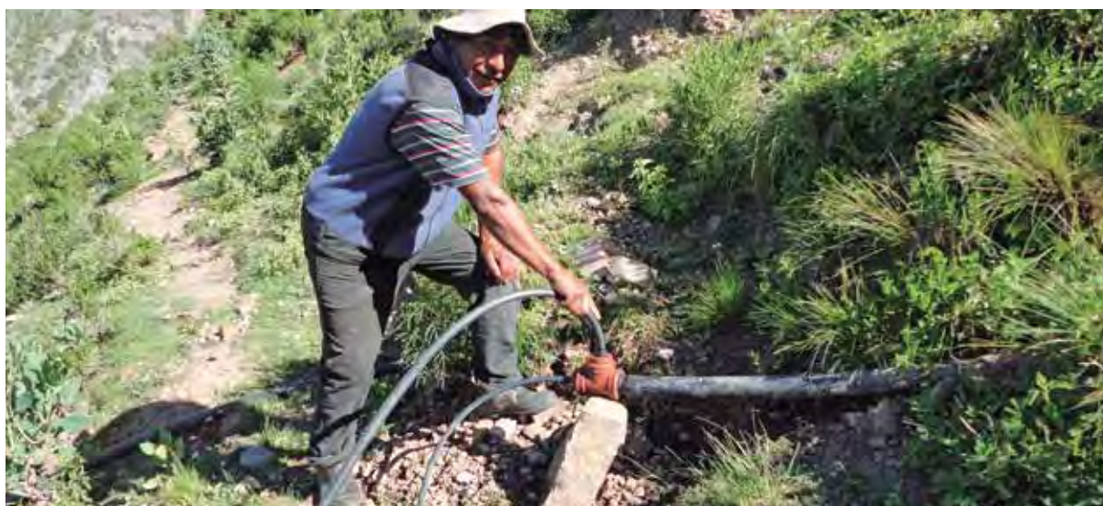
Productor Ángel Montoya mostrando conexiones hídricas. Obras hídricas familiares de la Comunidad Aborigen de Punta Corral. Departamento Tumbaya, Quebrada de Humahuaca, Jujuy.
