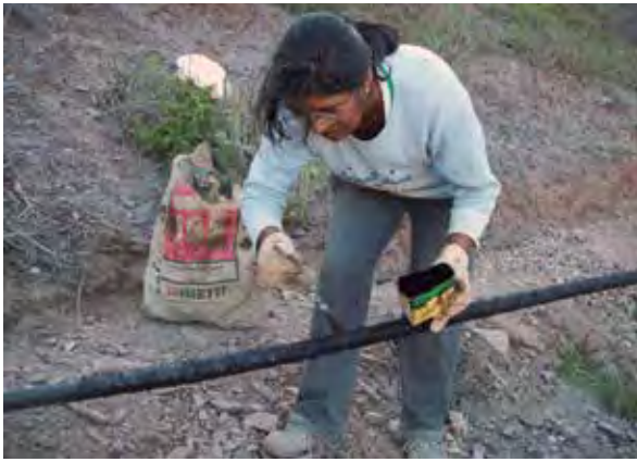
Protección del tramo expuesto de tubería en un cruce especial.
