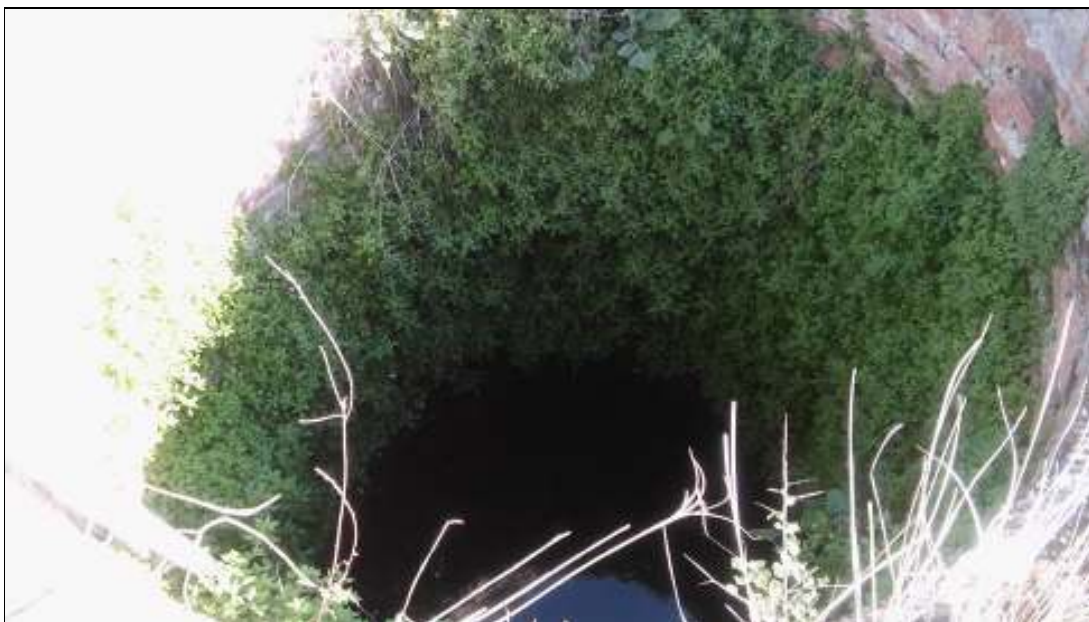
Interior del pozo calzado con abundante vegetación que debe ser extraída.
