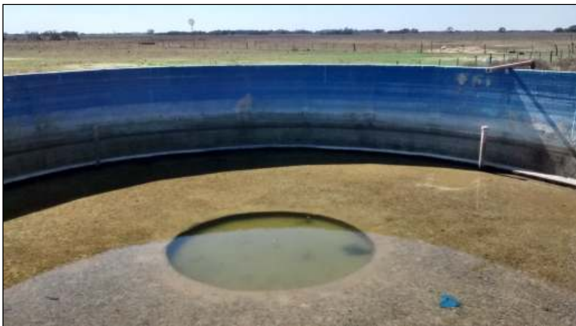
Interior del tanque australiano que tiene problemas de pérdidas de agua.
