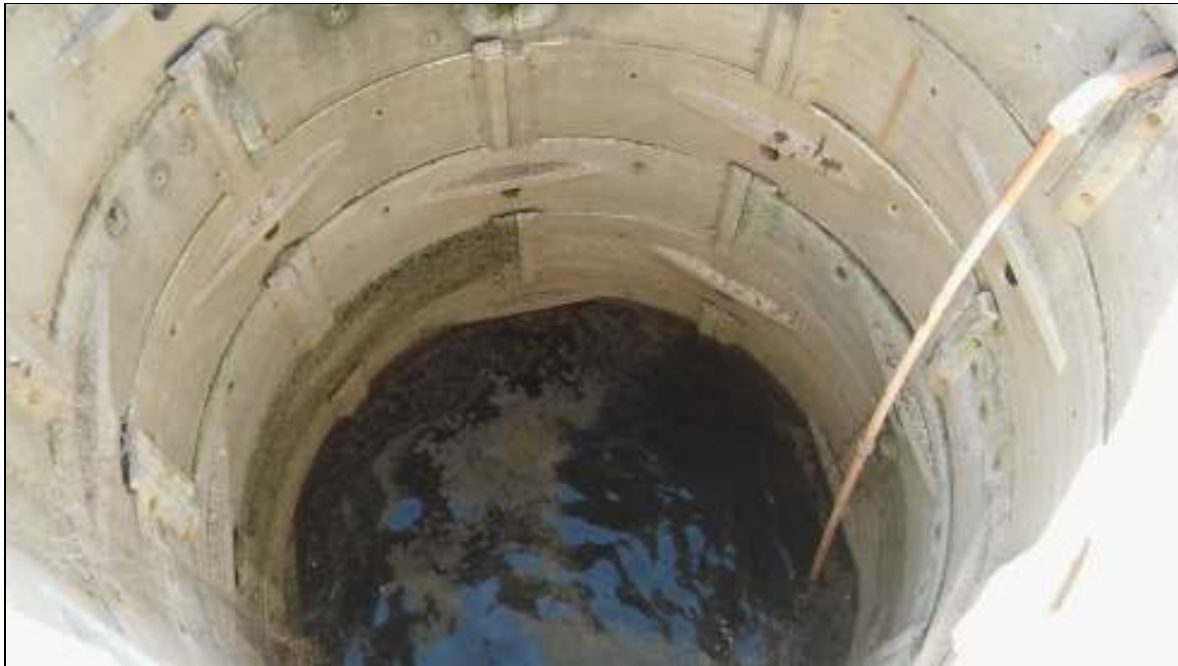
Interior del pozo calzado con placas premoldeadas. Es necesario limpiar la vegetación que existe y taparlo.
