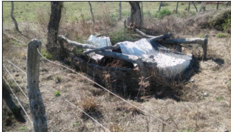
Situación del segundo pozo calzado, donde de manera urgente se debe mejorar el relleno con tierra por fuera y mejorar el tapado del mismo.
