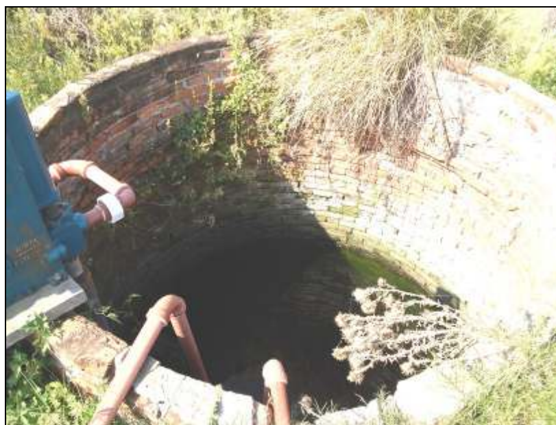
Fotografía de pozo calzado con mampostería. El mismo se recomienda se limpie de malezas y se tape adecuadamente.
