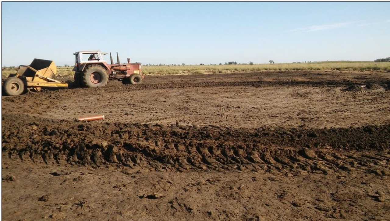
Base terminada. Comienzo de la construcción de la pared del tanque. Se observan las cañerías de polipropileno (PP) de 4 pulgadas de diámetro de salidas hacia el norte y el sur.
