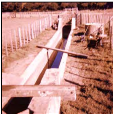
Bañadero de cemento con reborde superior; a la derecha el tanque de reserva y al fondo el escurridero.
