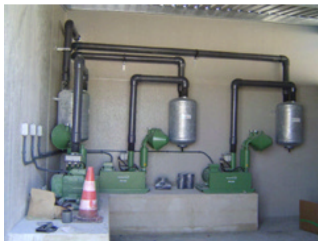
Bombas de vacío de paletas instaladas en serie
